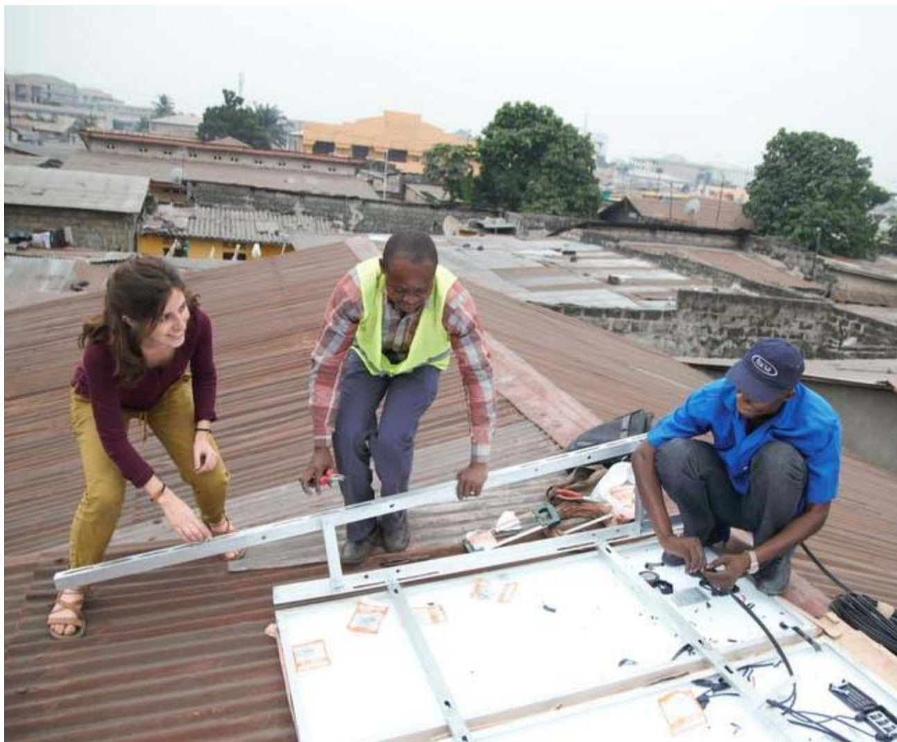
▲ Le projet a, notamment, consisté à installer des panneaux solaires sur les toits du centre de santé. © D.R.
